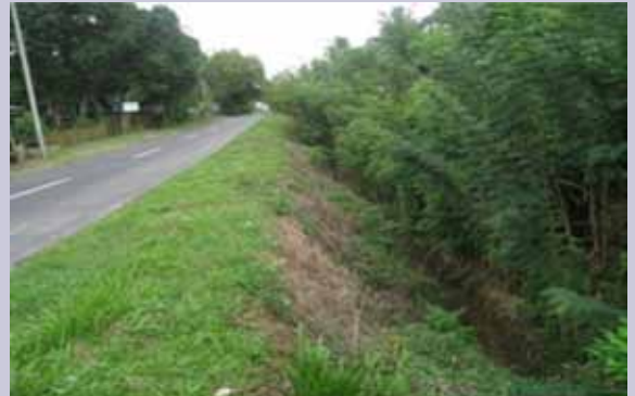
▲ Kemiringan sisi jalan yang tidak bisa dilalui
