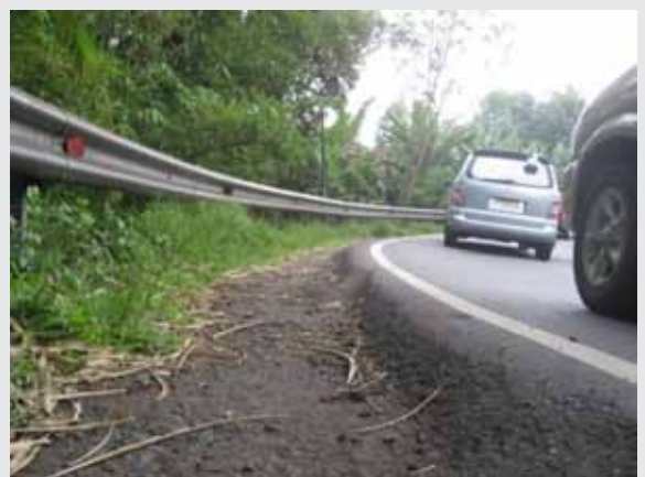
▲ Pagar terlalu rendah jika dibandingkan dengan permukaan jalan Pagar bertemu di arah yang salah
