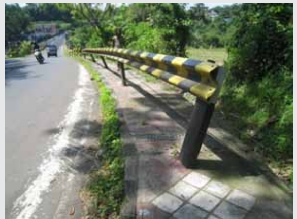
▲ Tidak ada terminal Terlalu tinggi
