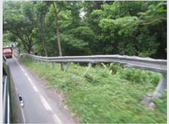
▲ Tidak ada pemeliharaan/perbaikan
