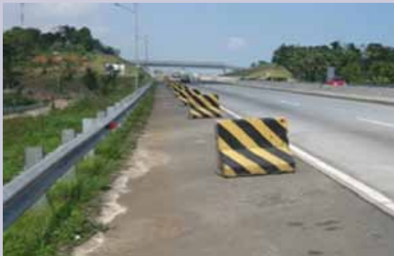
▲ Barikade beton digunakan secara tidak benar.
