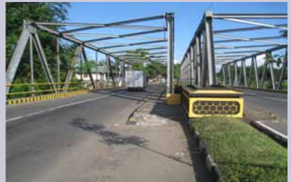
▲ Parapet jembatan tanpa pelindung
