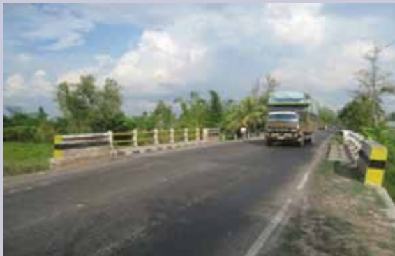
▲ Parapet jembatan tanpa pelindung
