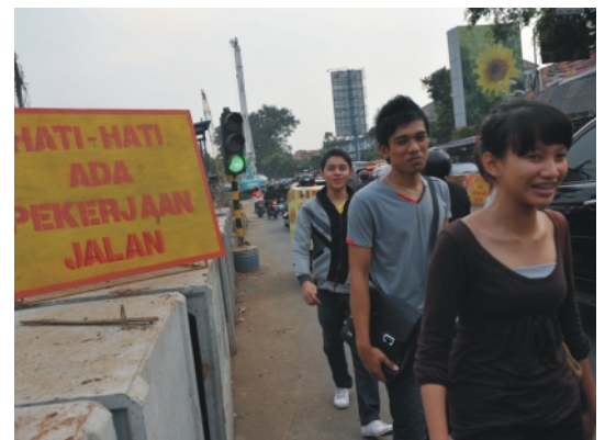
Jangan lupa menyediakan akses yang berkeselamatan bagi para pejalan kaki pada lokasi pekerjaan.
