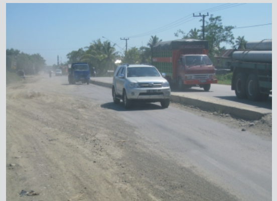
Penahapan pekerjaan jalan ini mempunyai banyak area kerja, masing-masing ada undakan perkerasan beton baru. Tanpa perambuan, setiap undakan memberikan kejutan bagi pengguna jalan.
