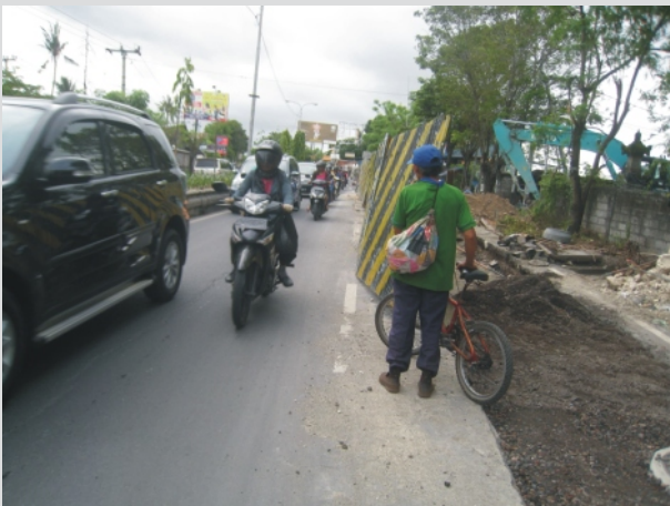
Pejalan kaki dan pesepeda jangan dilupakan pada lokasi pekerjaan jalan. Sangat sering, trotoar digunakan untuk aktivitas pekerjaan jalan dan pejalan kaki terpaksa berjalan di antara lalu lintas.
