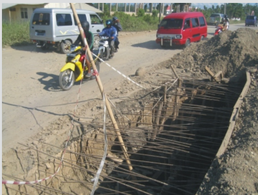
Pekerjaan galian ini tanpa delineasi dan pagar pelindung. Ini menyebabkan risiko tinggi bagi pengguna jalan, khususnya pada malam hari.
