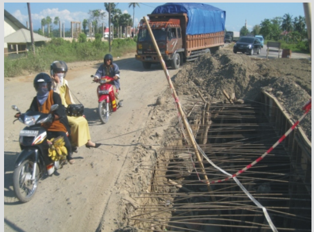
Pengguna jalan diijinkan terlalu dekat dengan hazard/bahaya besar. Tidak terdapat delineasi dan pengaturan batas kecepatan.
