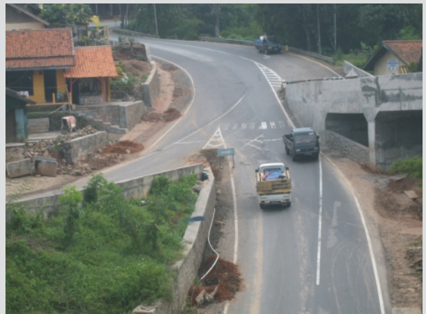
Tidak terdapat manajemen lalu lintas untuk memandu atau mengarahkan pengguna jalan saat jembatan layang sedang dibangun. Marka jalan eksisting dapat menyesatkan beberapa pengemudi dan dapat menyebabkan konflik depan-depan.
