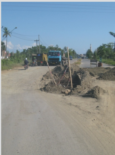
Hazard/bahaya yang sangat dekat dengan suatu jalan harus diberi deliniasi yang baik. Kecepatan harus dijaga rendah. Lokasi ini tidak mempunyai rambu dan deliniasi dasar.
