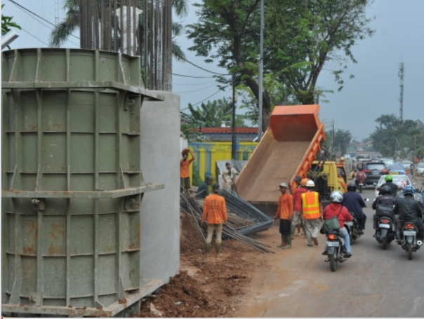
Tidak terdapat delineasi atau pagar keselamatan untuk memisahkan lokasi kerja dari lalu lintas.
