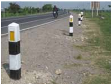
Patok pengarah beton bertulang memberi delineasi yang baik, tetapi merupakan hazard yang tidak perlu di sepanjang sisi jalan.
