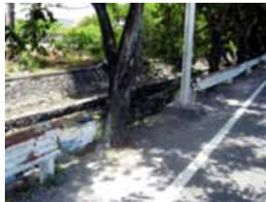
Bagian pagar yang hilang membuka hazard yang tidak tertutupi.
