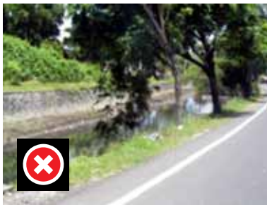
Saluran ini merupakan hazard di sisi jalan yang harus ditutupi untuk meningkatkan keselamatan.
