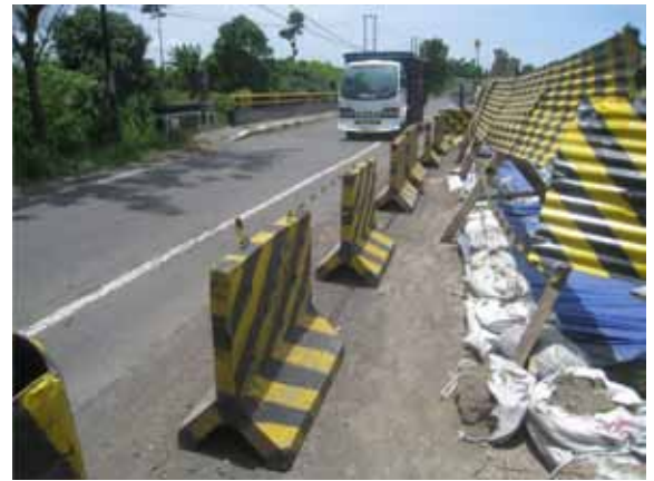
Gambar 3.31 Balok beton ini memberikan delineator yang baik tetapi merupakan bahaya apabila tertabrak. Balok ini tidak memiliki kapabilitas untuk mengembalikan arah kenderaan dan tidak disarankan digunakan sebagai pagar keselamatan.
