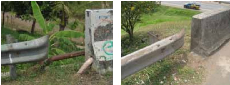
Gambar 4.8 Sambungan yang tidak baik.
