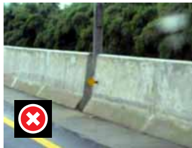
Tiang lampu dalam pagar beton ini membuat celah yang dapat menjadi bahaya lekukan jika ditabrak oleh kendaraan berkecepatan tinggi.
