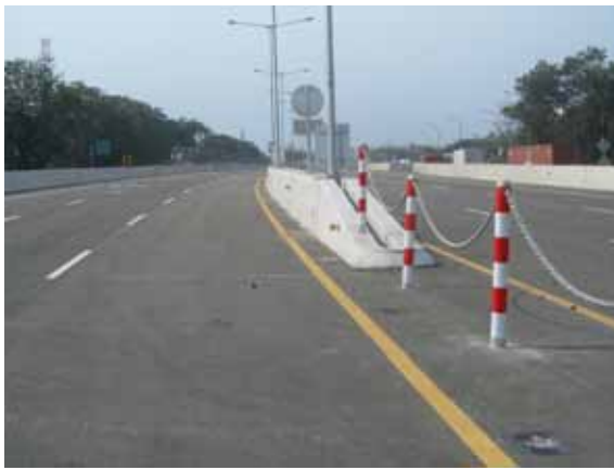
Gambar 3.29 Bukaan median pada jalan bebas hambatan baru ini, memiliki ujung pagar menaik yang tidak aman. Median ini juga dapat digunakan sebagai putarn-U karena patok/bollard int mudah dipindahkan. Pagar baja (lihat gambar sebelumnya) pada bukaan tersebut direkomendasikan sebagai pilihan yang lebih aman.
