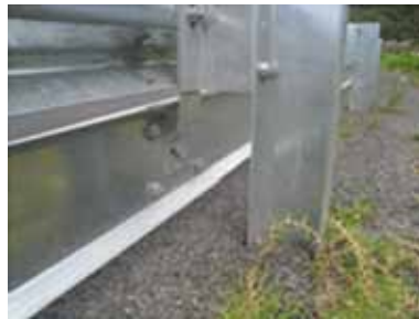
Gambar 4.10 Pelat baja pelindung sepeda motor dipasang di bagian bawah pagar.
