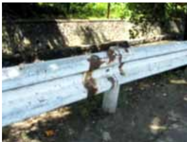
(a) Baut yang hilang dari pagar akan mempengaruhi kinerja terhadap kecelakaan.
