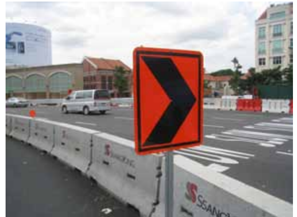
Gambar 3.33 Setiap bagian pagar beton sementara tersambung dengan kokoh membentuk pagar menerus. Lubang kecil dibawahnya memungkinkan aliran air dapat melalui pagar sehingga mereduksi genangan air di jalan.
