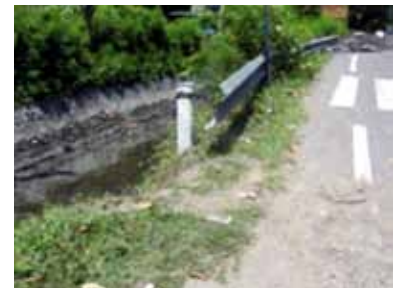
Pagar keselamatan yang tidak terikat tiang-tiang dan bagian-bagian yang hilang dari pagar keselamatan akan berakibat pagar tidak bekerja seperti yang diharapkan apabila terjadi kecelakaan.
