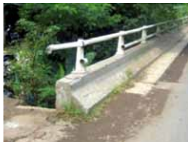
Gambar 4.7 Pagar jembatan kurang baik. Pagar jembatan ini berbahaya karena pagar dapat menusuk ke dalam kendaraan. Sambungan pagar ke parapet jembatan tidak menerus, dan pada kecelakaan pagar akan berdefleksi dan menyebabkan kendaraan masuk 'terjepit' ke ujung parapet jembatan.
